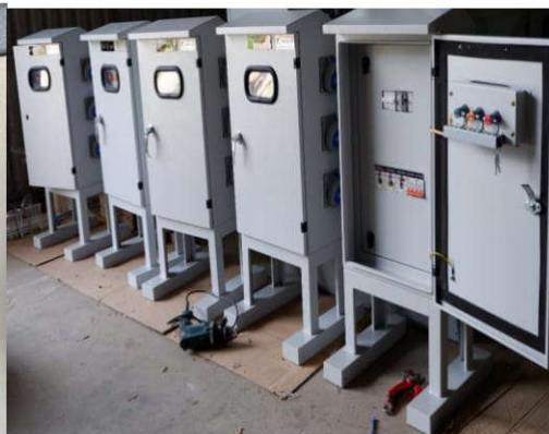
TỦ NGUỒN TẠM TEMPORARY SOURCE
