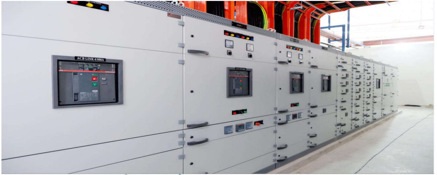
TỦ ĐIỆN CHÍNH / MAIN ELECTRIC
