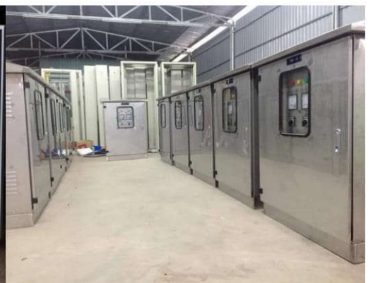
TỦ CHIẾU SÁNG CÔNG CỘNG PUBLIC LIGHTING BOX
