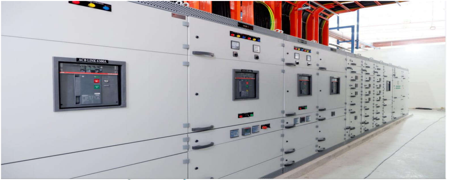
TỦ ĐIỆN CHÍNH / MAIN ELECTRIC
