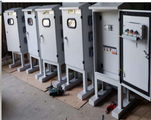
TỦ NGUỒN TẠM TEMPORARY SOURCE
