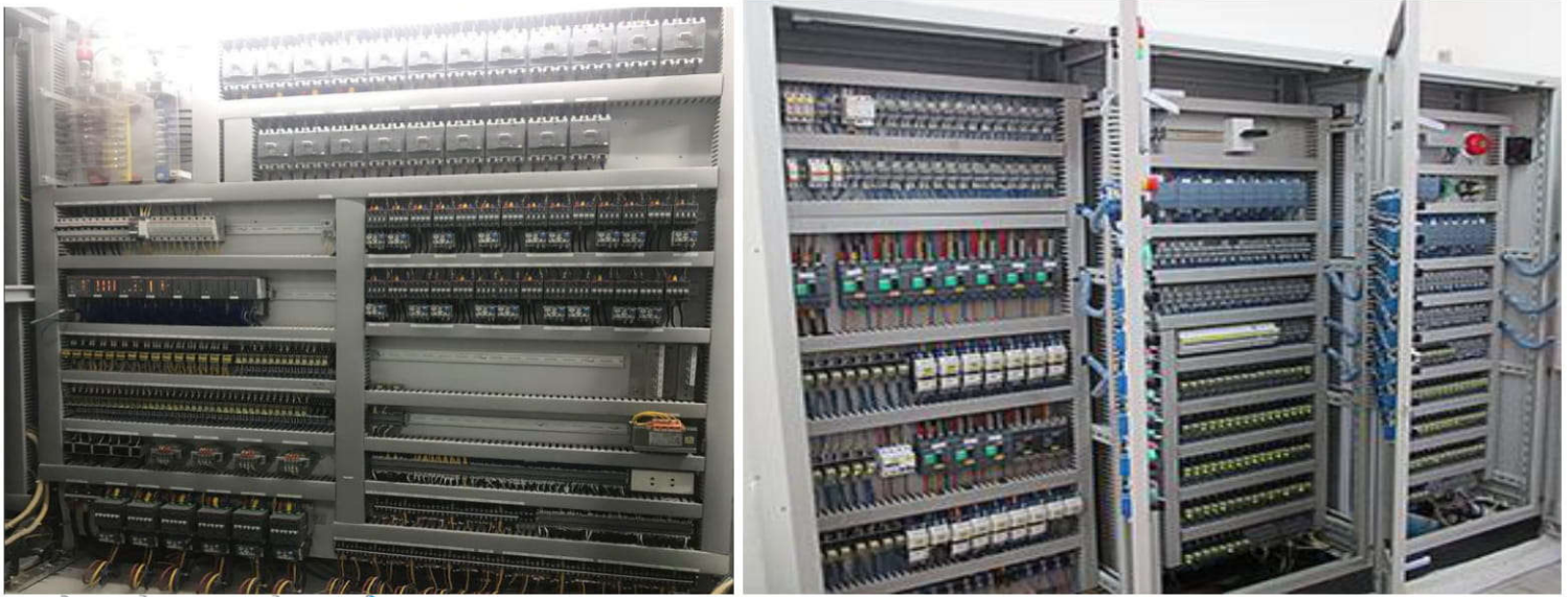
TỦ ĐIỀU KHIỂN CÔNG NGHỆ PLC / PLC TECHNOLOGY DEVELOPMENT CABINET
